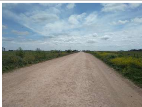
Vista de Av. Del Maestro (de tierra), desde boca calle intersección con Prolongación de Calle 4.
